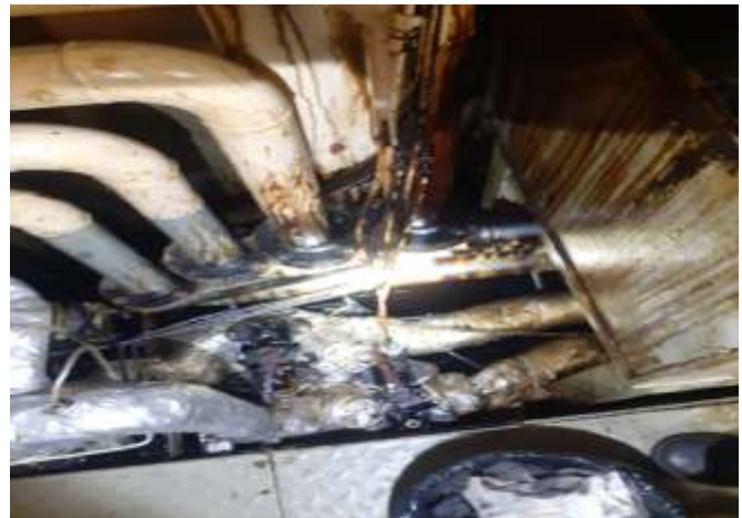
PHOTO D'UNE DEFECTUOSITE IDENTIFIEE
