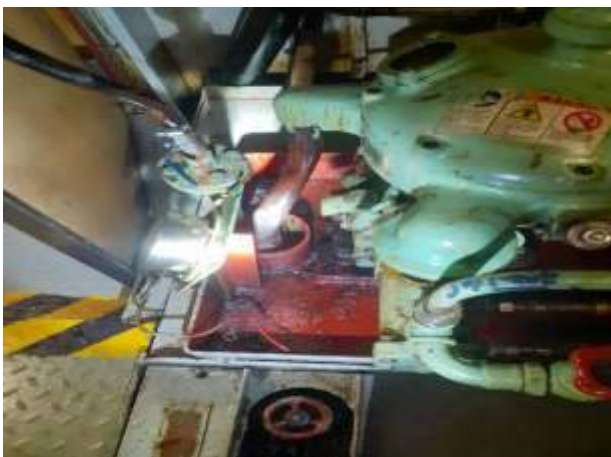
PHOTO D'UNE DEFECTUOSITE IDENTIFIEE
