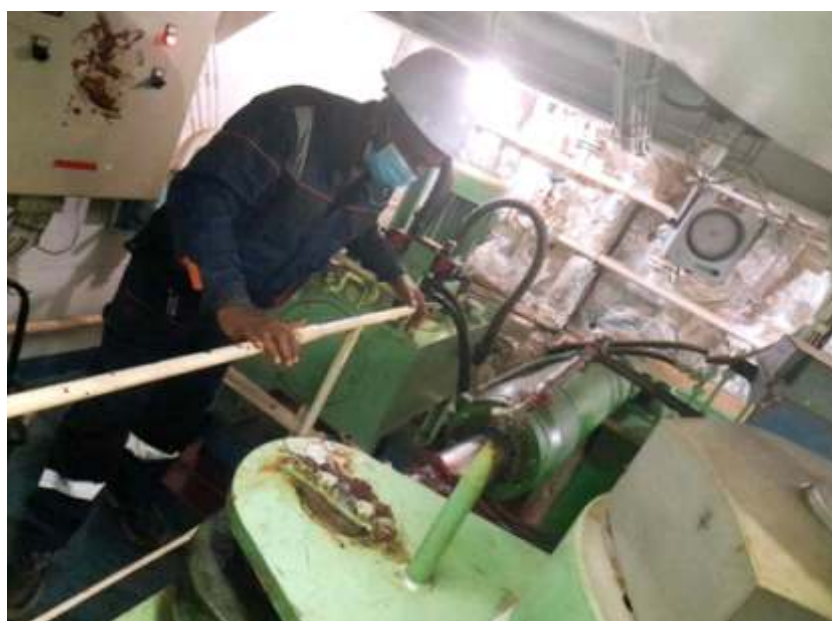
OCNEP INSPECTANT LE SYSTEME HYDRAULIQUE DE L'APPAREIL A GOUVERNER
