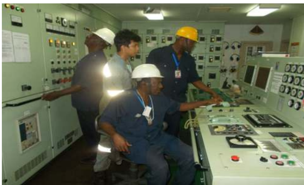
OCNEP INSPECTANT SALLE DE CONTROLE DES MOTEURS DES NAVIRES
