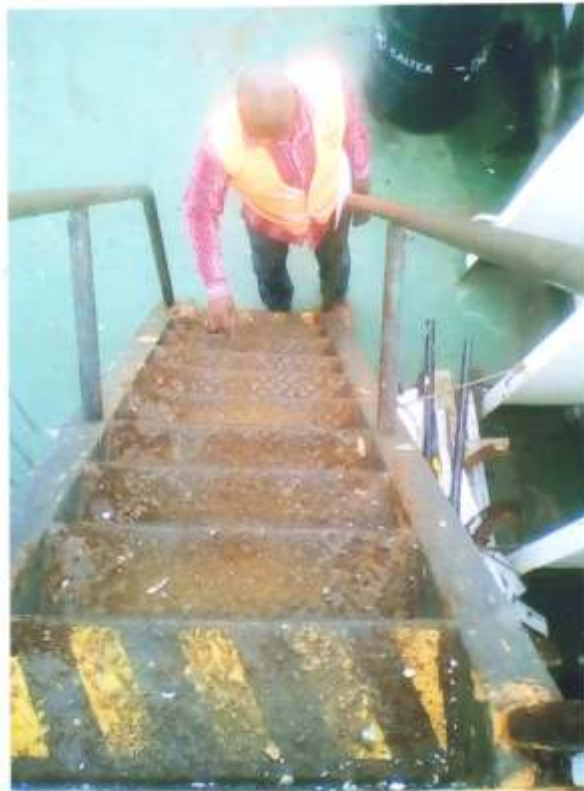
Escalier corrodé et gate
