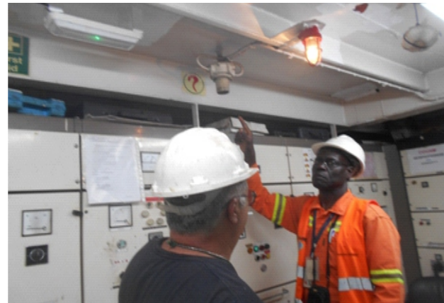
Un OCNEP sénégalais inspecte l'alarme du détecteur de fumée dans la salle de contrôle des machines
