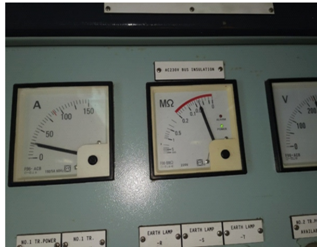
Défaut d'isolement électrique 220 volts
