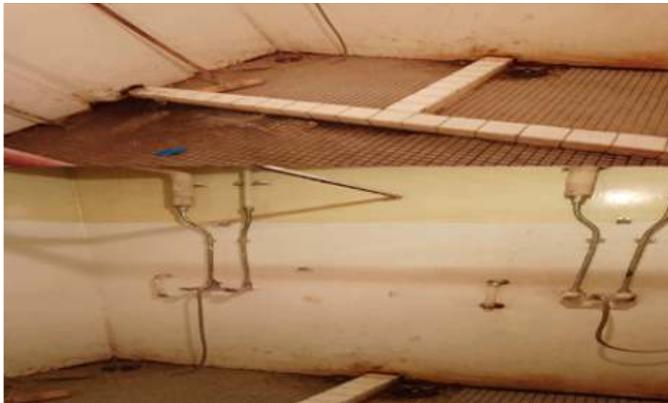
Il a été observé lors d'une inspection que la cabine de douche était sale et que les tuyaux de douche étaient abîmés.
