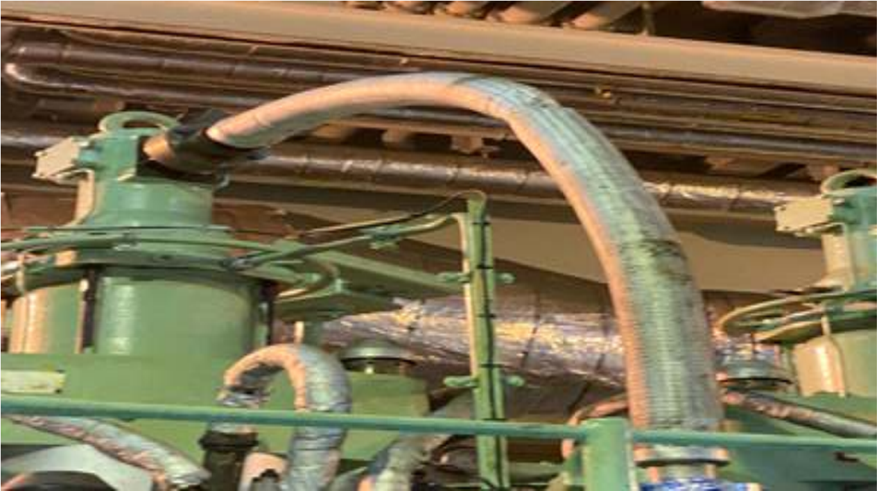
Un tuyau haute pression endommagé
