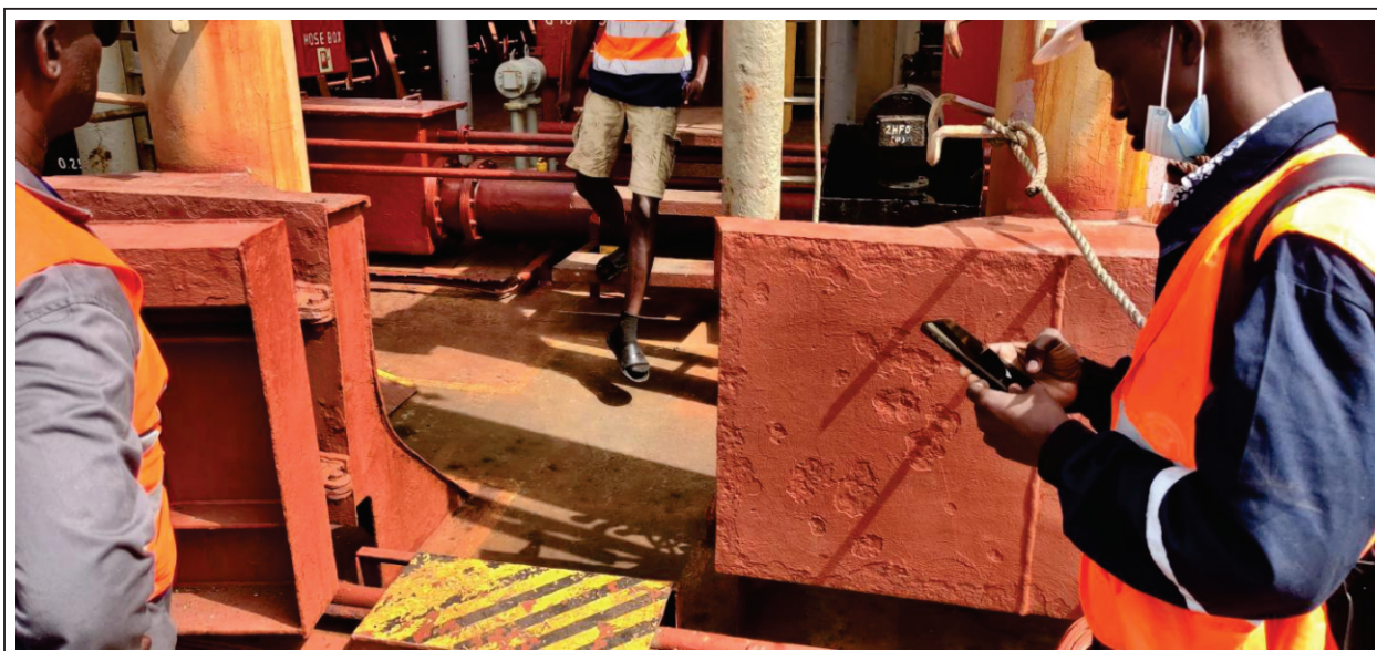
No Guard rail on Stairs Pas de garde-corps sur les marches
