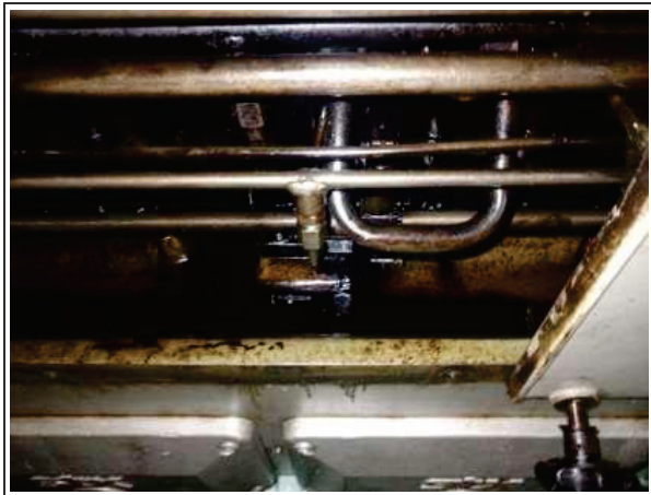
auxiliaries' engines cylinders leaking oil Des fuites d'huile ont été constatées sur les cylindres des moteurs auxiliaires
