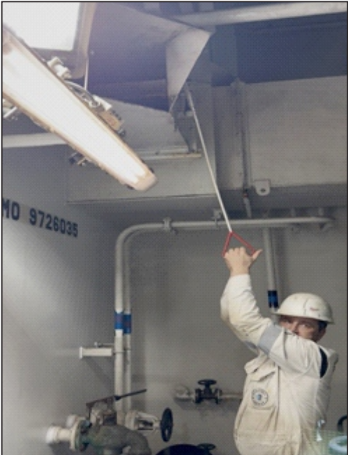
Engine Room Fire Damper not operational Volet coupe-feu de la salle des machines hors service
