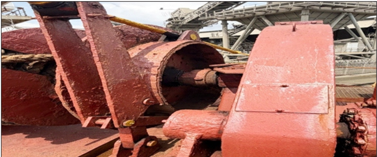
Mooring windlass brake Lining Worn Garniture de frein de guindeau d'amarrage usée
