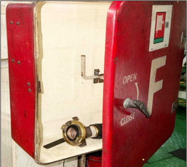
Fire hose missing from the box Lance-incendie manquante dans le coffre
