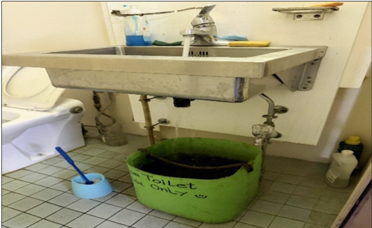
Engine Room washing hand basing Leaking Fuite au niveau du lavabo de la salle des machines
