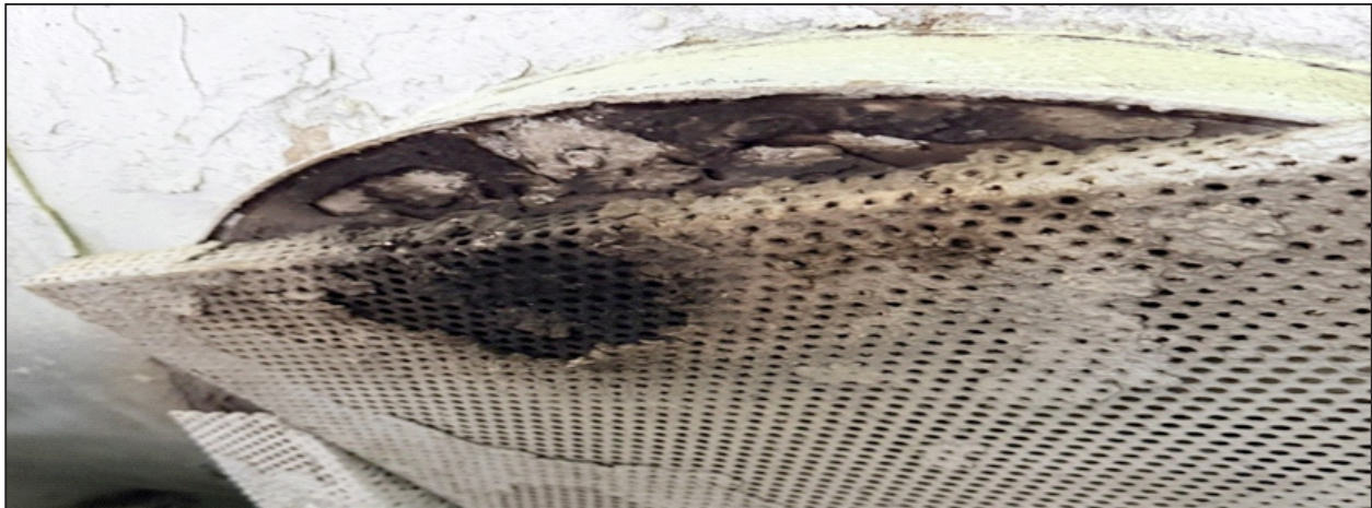
Main Engine Leaking Exhaust from the Manifold Fuite de gaz d'échappement au niveau du collecteur du moteur principal
