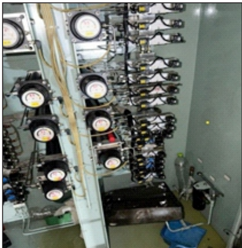
Oil Leak from Solenoid Valve Cabinet Fuite d'huile au niveau de l'armoire de vannes solénoïdes
