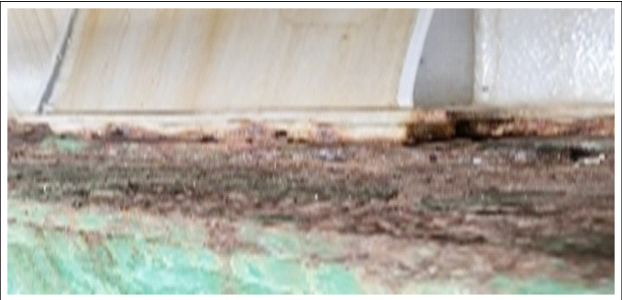
Corroded and wasted steel plates Dégradation avancée des tôles d'acier avec corrosion et perte d'épaisseur visible
