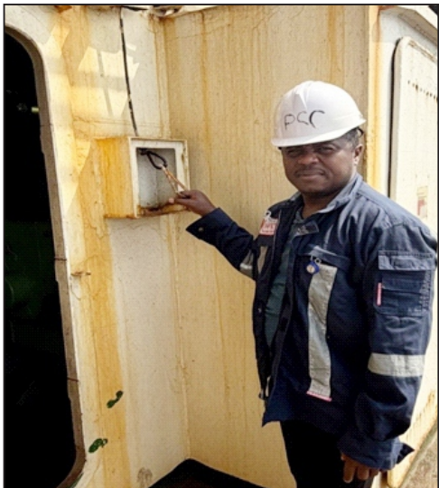
Emergency Generator Quick closing Valve Seizure Coincement de la vanne à fermeture rapide du générateur de secours
